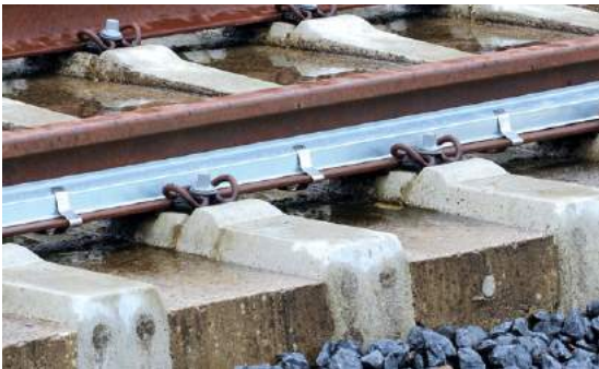
Streckenverkabelung mit ClipFix
