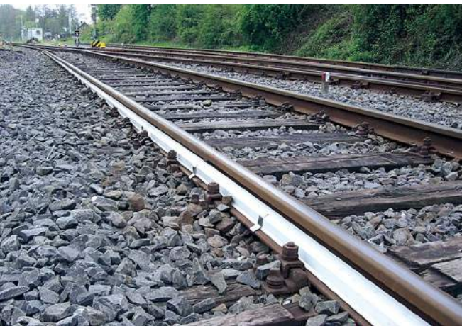
Streckenverkabelung mit ClipFix
