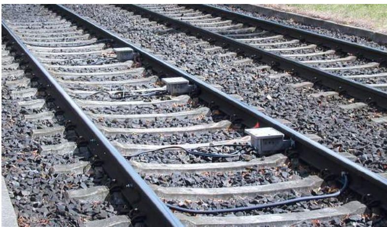
Gleiskästen zur Anwendung im Weichensperrkreis
