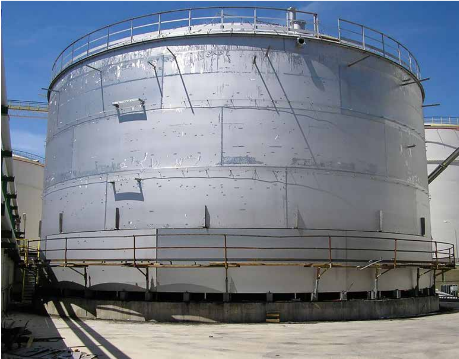
Gebeizter Lagertank aus Duplex-Stahl 2304
